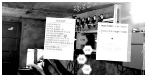
图10 通过AR向巡检人员推送设备检修任务指导
